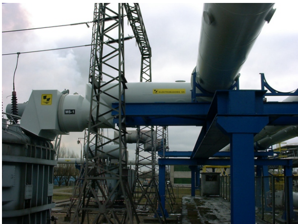
Conexión del transformador Connection to transformer
