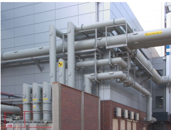
Los preparativos de la canal en una planta de potencia Busduct arrangement in a power station
