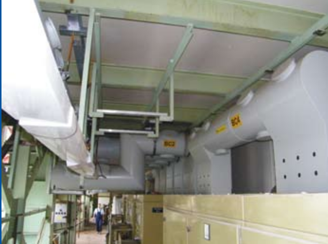
Przyłącze do rozdzielni Connection to MV switchgear
