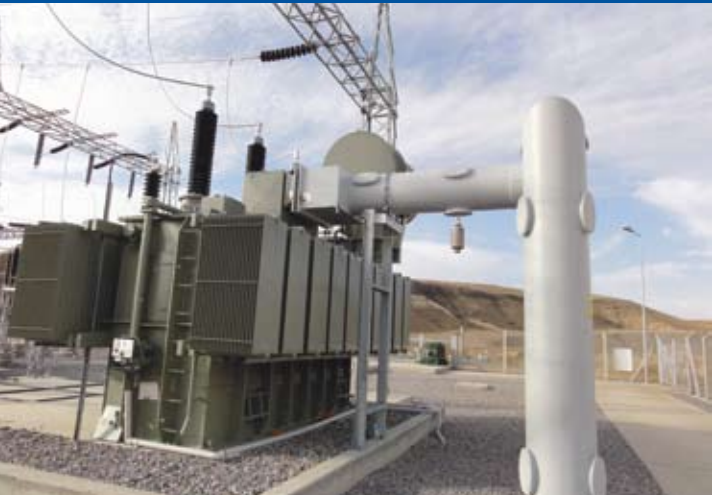
Przyłącze do transformatora potrzeb własnych Connection to auxiliary transformer
